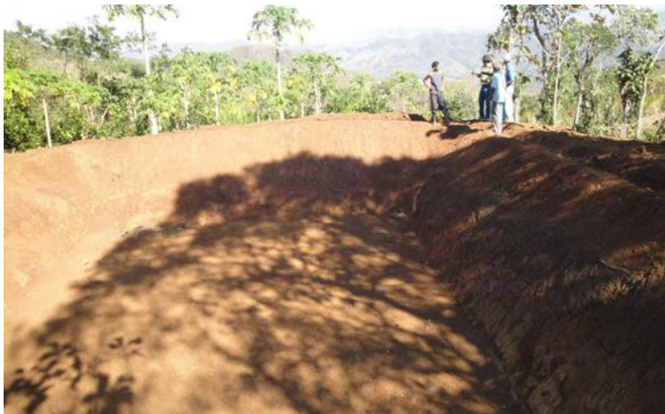
Figura 2. Reservorio tipo excavado construido en Cerro Negro de Nicoya, Guanacaste. Fuente: Adolfo Salinas Acosta, 2009
