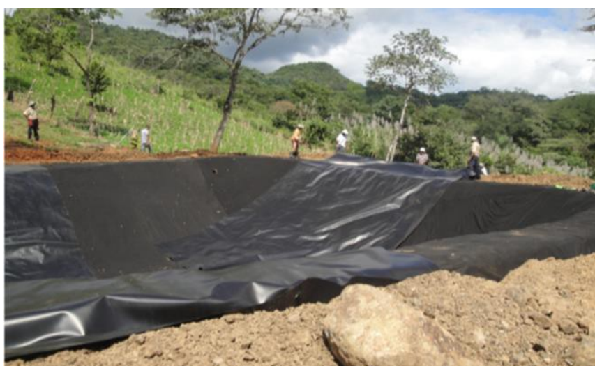
Figura 8. Revestimiento de geomembrana. Fuente: Adolfo Salinas Acosta, 2009
